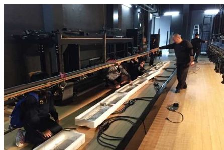
グラントワ中ホールの照明を点検するスタッフ
